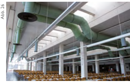
Abb. 26 Markant: die großen Lüftungsrohre im Speisesaal.
